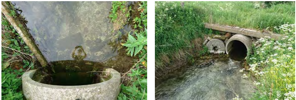
Figur 3-7: Overkørsel i Skiveren st. 915-923 hhv. opstrøms og nedstrøms side. Læg mærke til den kraftige strøm i udløbet samt det markante skyllehul nedstrøms herfor
